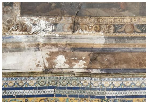
Fisura en el muro oeste y desplazamiento del zócalo [JMS]
