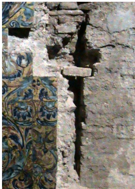
Detalle de la fisura longitudinal del muro oeste
