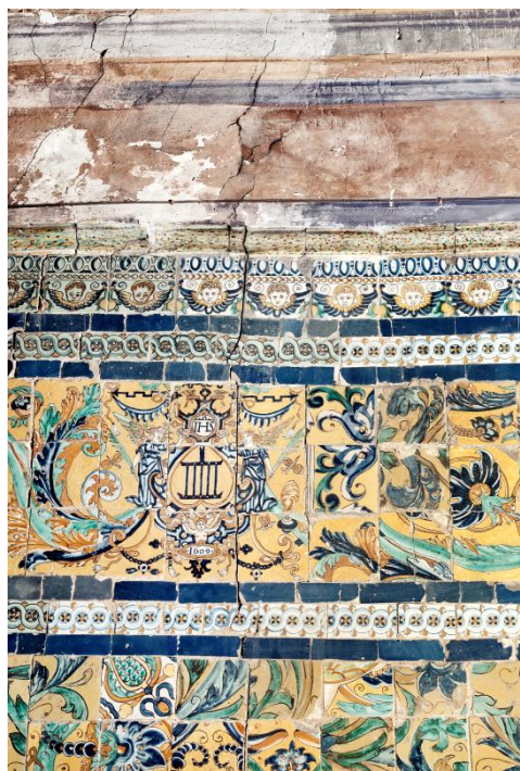
La fisura que recorre verticalmente el muro oeste afectaba de forma muy grave al zócalo cerámico
